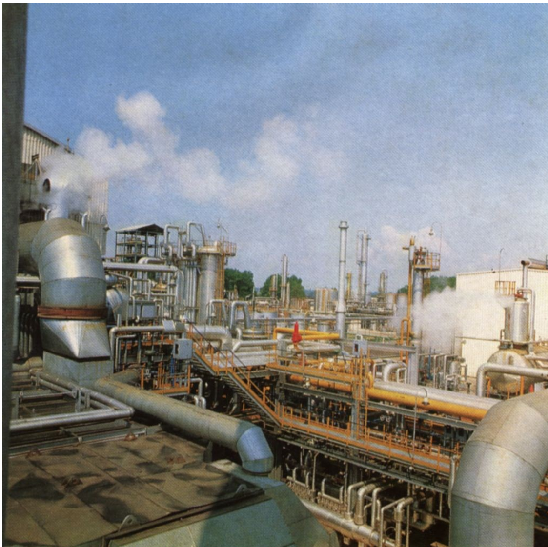
Slika 2: Plinski cevovod v Petišovcih (vir: Delo)
