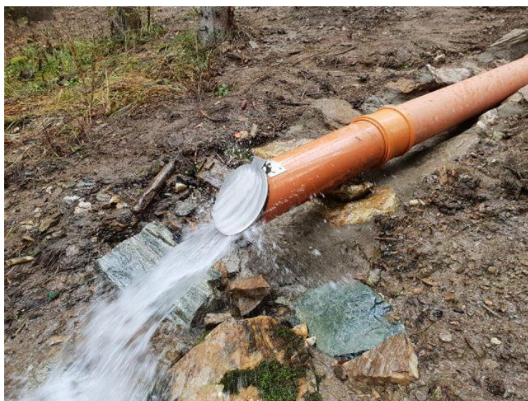
Slika 15: Objekt – izpust na vodovodu Mlake.
