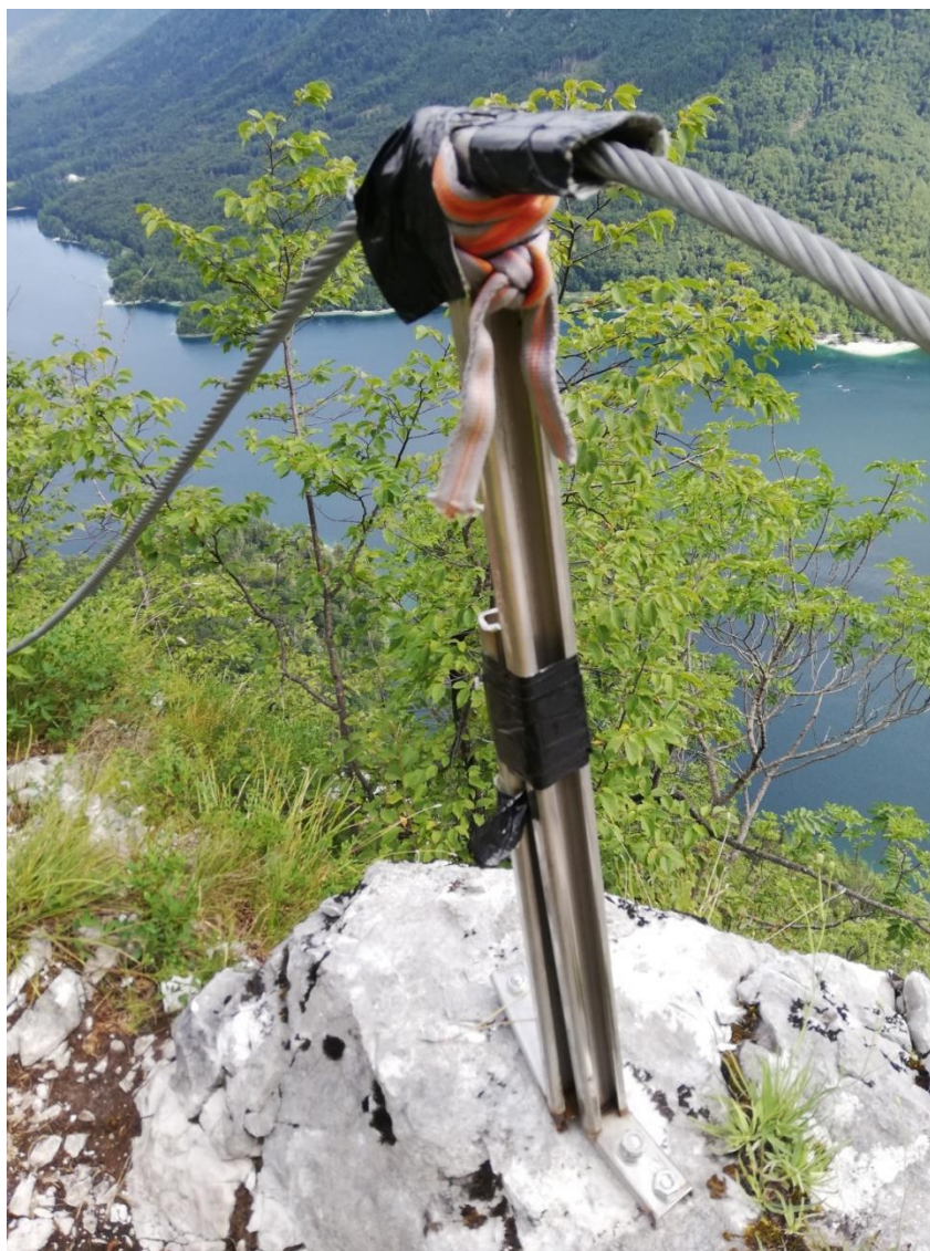
Slika 29: Neprimerno vzdrževanje poti Ožarjeni kamen nad Bohinjskim jezerom (foto: A. Prezel, 2019)
