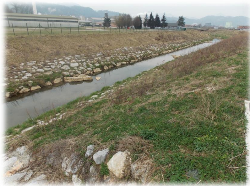
Slika 10: Primer protipoplavnega nasipa na Vzhodni Ložnici
