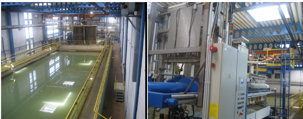
Slika 4: Centralna čistilna naprava v Gorenju (vir: lasten)
